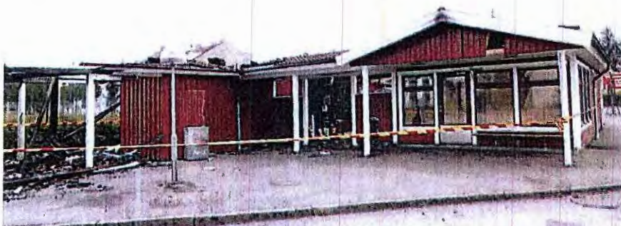
Byggnaden intill har klarat sig relativt bra från branden. Taket har fått skador, då värmen från den östra delen spridit sig genom takloftet.
